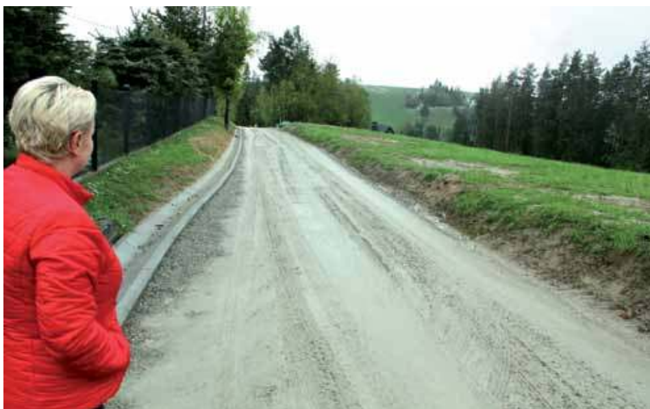
Droga na Marfianą Górę rozkopana jest już 9. miesiąc.
