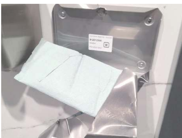
Pojemników na papier nie da się ponownie zamontować na ścianę. Wymagają wymiany
