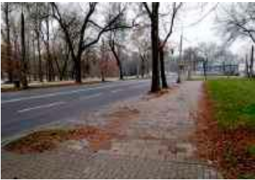
Urzednicy szacują, że na wyremontowanie brakującego, niewielkiego odcinka chodnika potrzeba ponad 40 tys. zł
