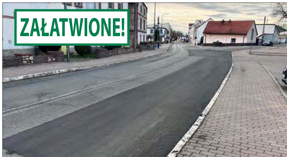
Niebezpieczne wybrzuszenie zniknęło.
