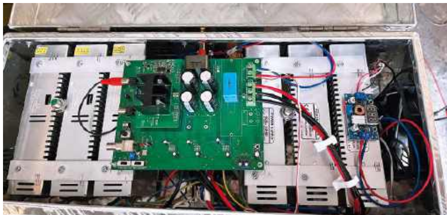
Fotografia 2. Zasilacze impulsowe ładnie mieszczą się w aluminiowej skrzynce narzędziowej; moduł wzmacniacza o mocy 1 kW zajmuje niewielką powierzchnię na górze, jest zamontowany na plastikowych izolatorach. Niewielki moduł po prawej stronie dostarcza napięcie 12 V z jednego z zasilaczy 24 V do zasilania wentylatora i lampki wskaźnika wysterowania (fotografia 4). Zwróć uwagę na duże śruby nierdzewne, którymi przytwierdzono zasilacze impulsowe
