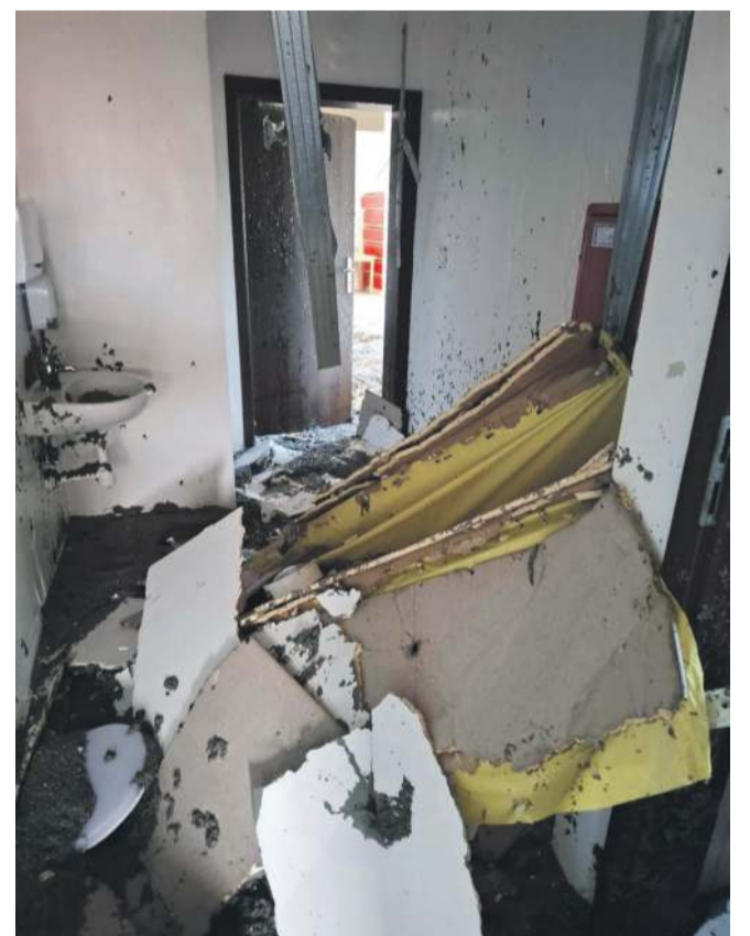
Tak wyglądała świetlica zaraz po zawaleniu się podwieszanego stropu
