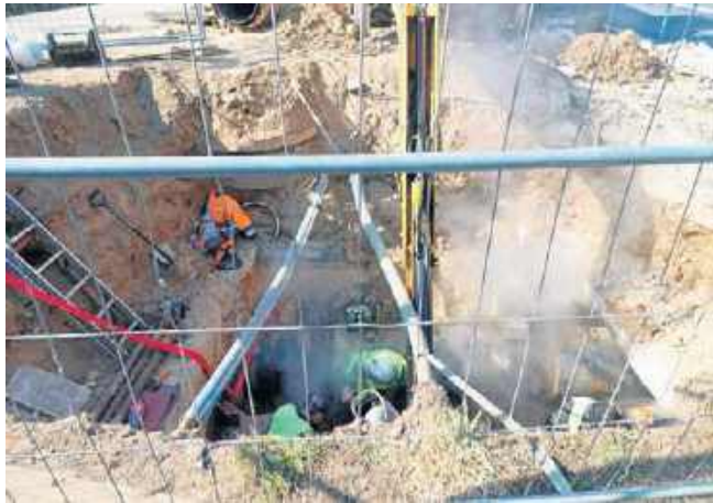
Awaria Radpecu, róg Toruńskiej i Wierzbickiej. Zajęli pas do skrótu w prawo, ekipy pracują, para bucha.
