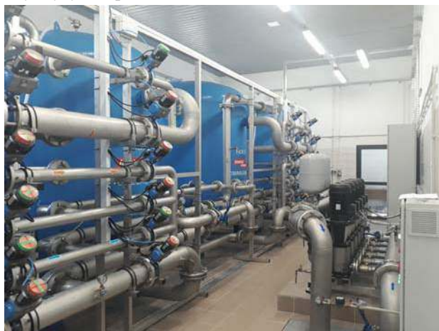
Stacja uzdatniania wody w Nowej Różance
