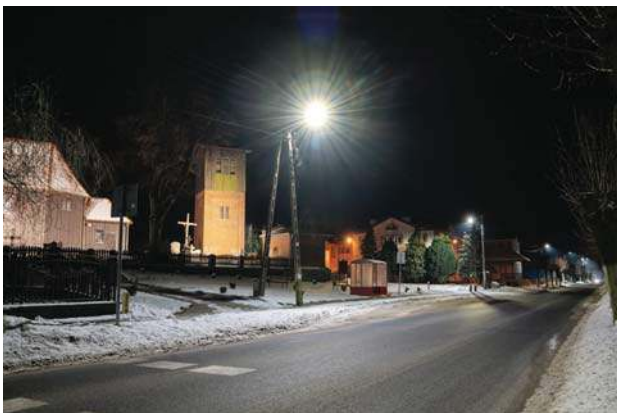
We wszystkich miejscowościach zainstalowano ponad 1000 nowoczesnych lamp typu LED
