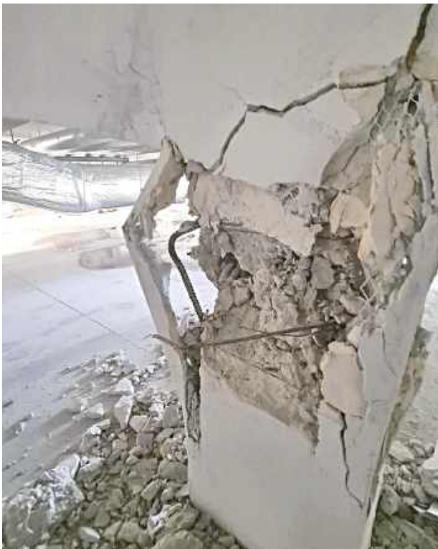
Tak wygląda uszkodzony słup żelbetonowy podbierający nieckę basenową
