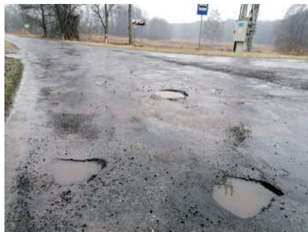
KOLONIA BORÓW. Takie dziury na drodze Chodel - Borzechów, która prowadzi do granicy z powiatem lubelskim, były wiosną. Powiat walczy o dotację na przebudowę 4-kilometrowego odcinka
