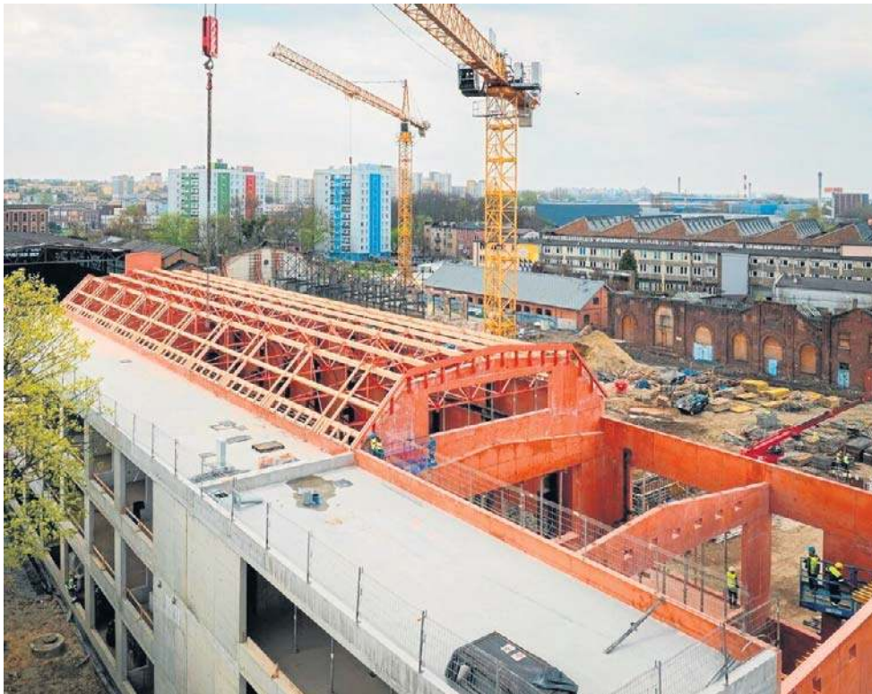
Tak obecnie wygląda budowa nowego śródmieścia i rynku w Dąbrowie Górniczej, na terenie byłej Dąbrowskiej Fabryki Obrabiarek Defum
