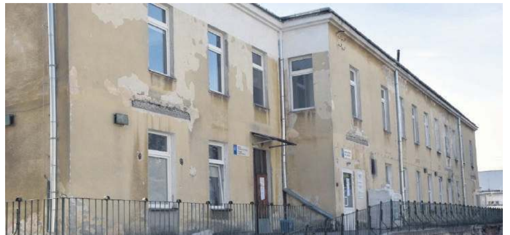
Budynek dosłownie rozpada się.
