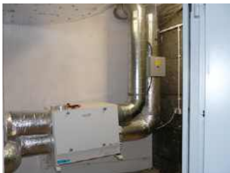
Instalacja wentylacyjna to system – każdy z jej elementów wpływa na pozostałe. PRO-VENT
