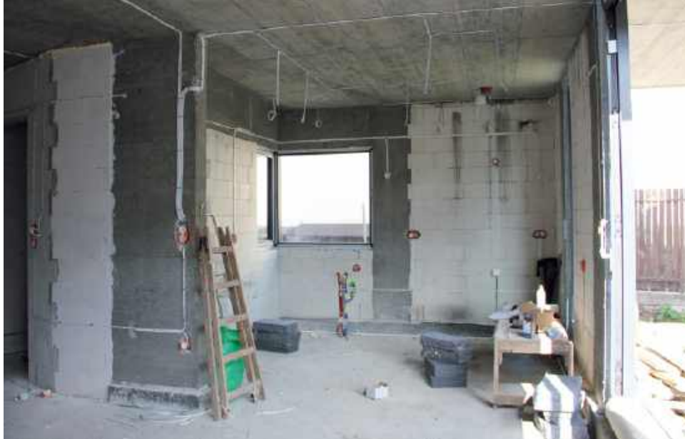
Instalacja elektryczna rozprowadzona na ścianach i suficie kuchni. J. WERNER
