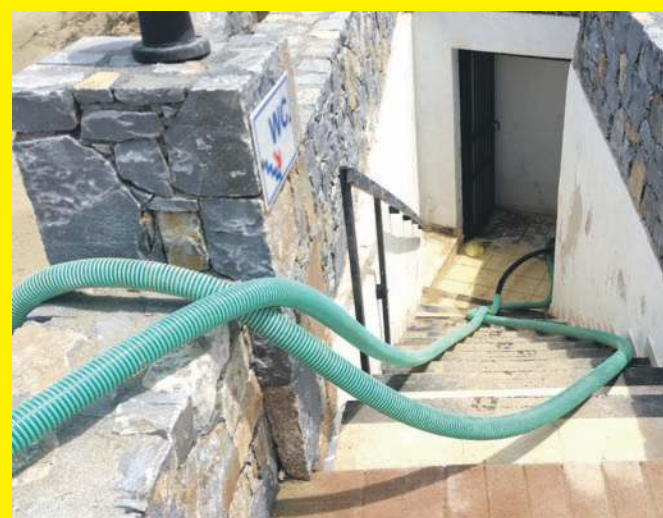
To wejście do nieczynnej toalety przy basenie
