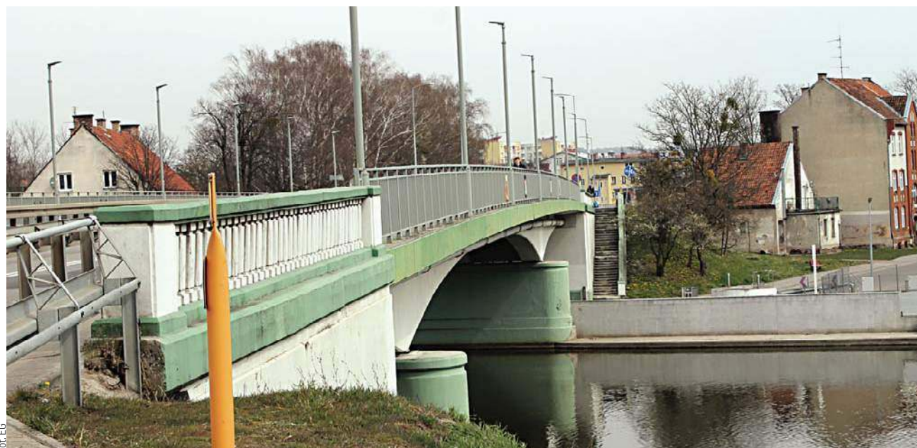
W ekspertyzie ważność warunków dalszej eksploatacji mostu ustalono na koniec 2023 r.
