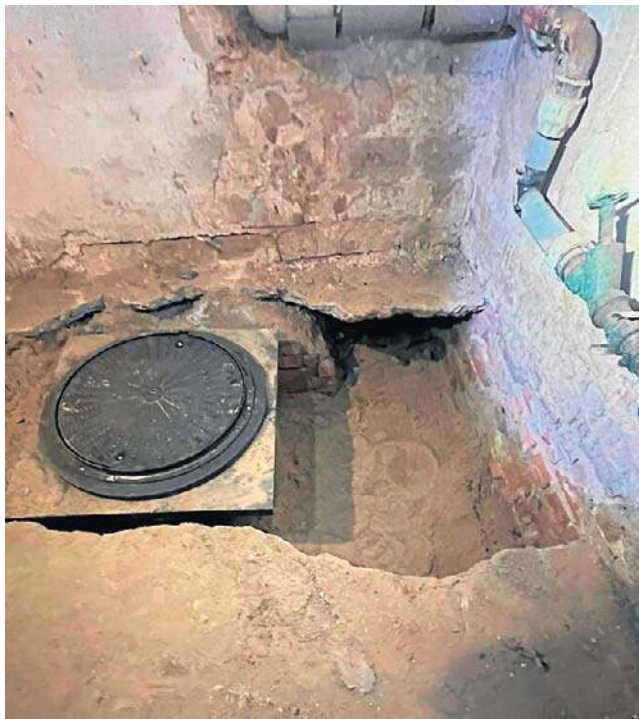
Stan piwnicy po realizacji zlecenia przez Zakład Wodociągów i Kanalizacji w Szczecinie
