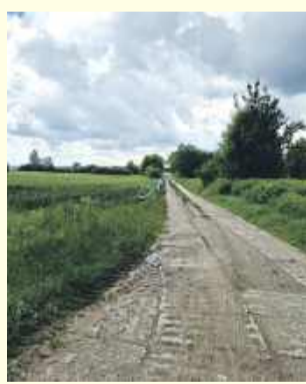
Na ul. Pierwoszowskiej w Wiszni Małej wykonano 847 metrów sieci wodociągowej wraz z odtworzeniem terenu po zakończeniu prac
