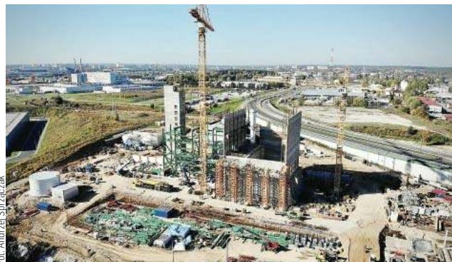
oddana instalacja kotłowni szczytowo-rezerwowej, gazowo-olejowej. Docelowo będzie ona służyć miastu jako rezer-
