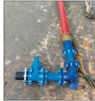
Nowoczesne rozwiązania hydrotechniczne zostały zastosowane w gminie Strzelecckiej.
