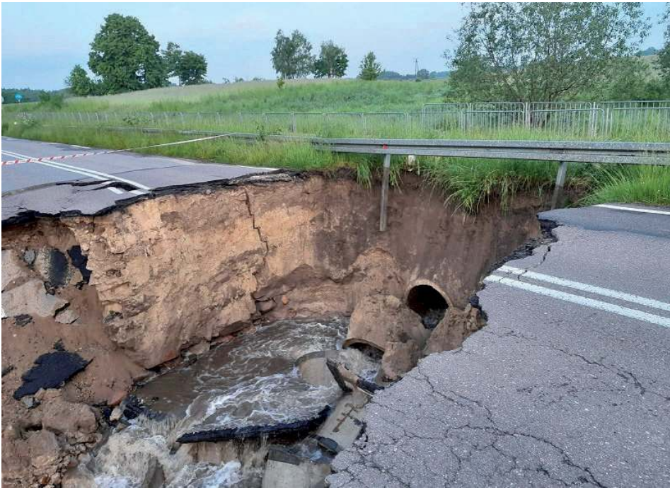
Rzeka podmyła ulicę, powstała wielka wyrwa
