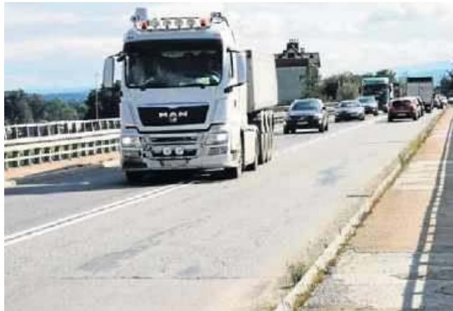
Istniejący most w Jankowicach jest w złym stanie i jak wynika z ekspertyz, remonty już nie wystarczą
