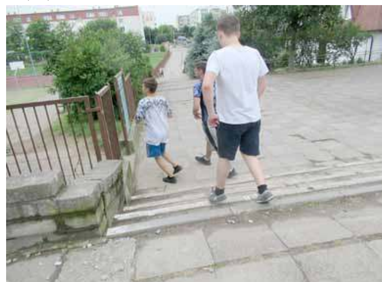
Schody przy wejściu do SP 3 wymagają remontu
