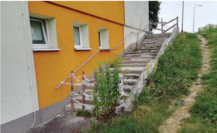
Zrujnowane schody mają zostać niebawem wyremontowane
