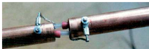
Fot. 3. Widok podłączonych kondensatorów
