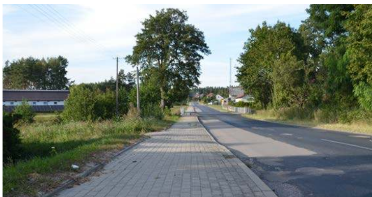
W fatalnym stanie jest nie tylko droga nr 212, ale i biegnący przy niej chodnik.
