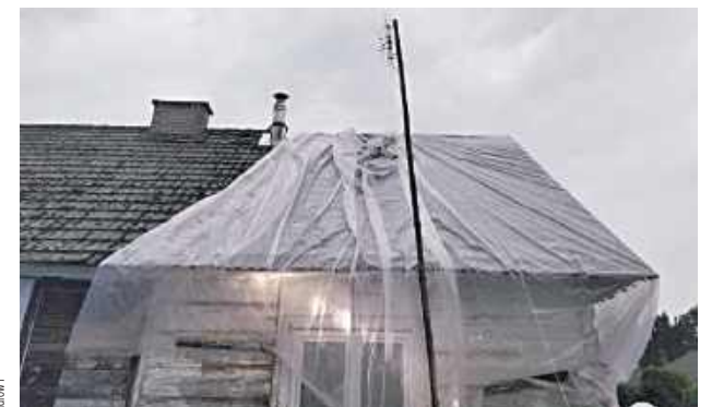
Strażacy pomagali przy zabezpieczeniu zerwanych dachów
