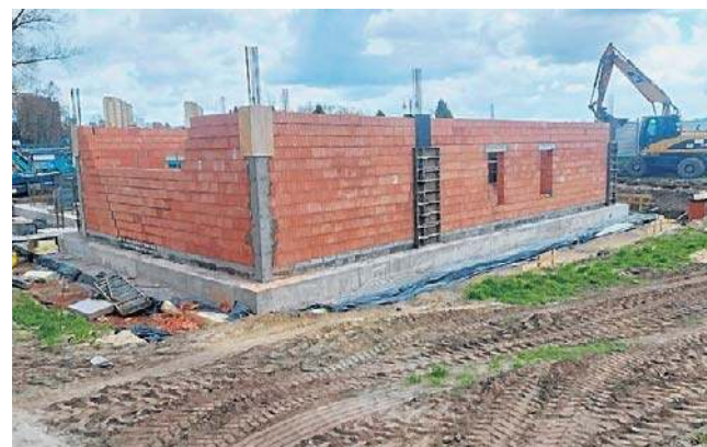
W miejsce starego młyna w Radomiu jest wznoszony nowy budynek. Już murują pierwsze ściany.
