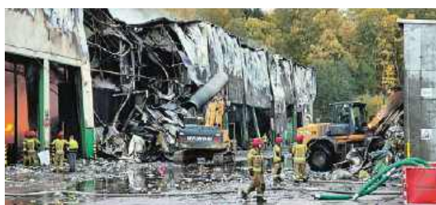
W sobotnim pożarze doszczętnie spłonęły hala sortowni oraz park maszynowy. W kulminacyjnym momencie z żywiołem walczyło ponad 100 strażaków
