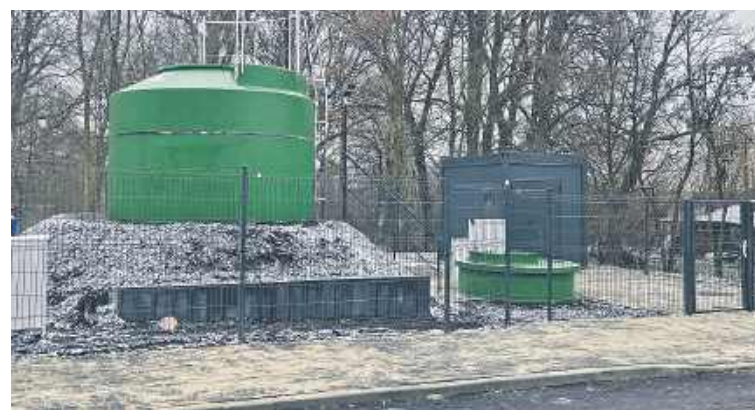
Oczyszczalnia ścieków w Brzezinach
