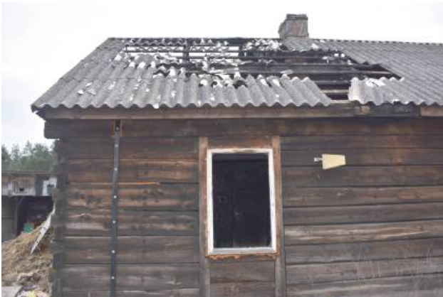
Ogień zniszczył strop i strych, cały dach jest do wymiany
