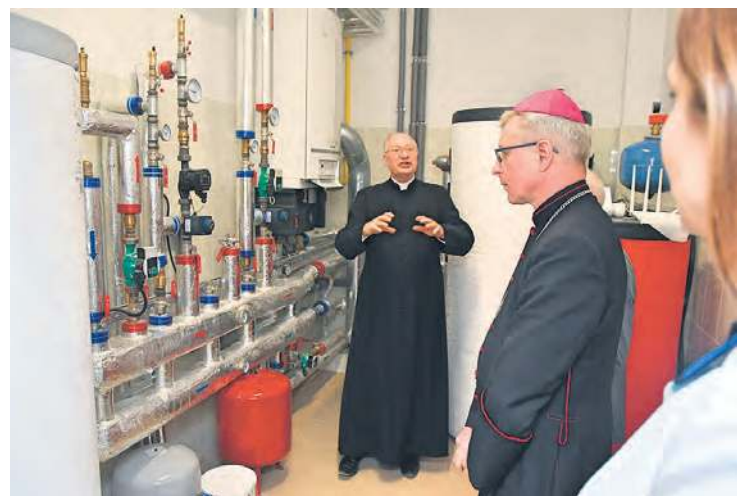
Nowoczesna kotłownia, która powstała w ramach projektu.
