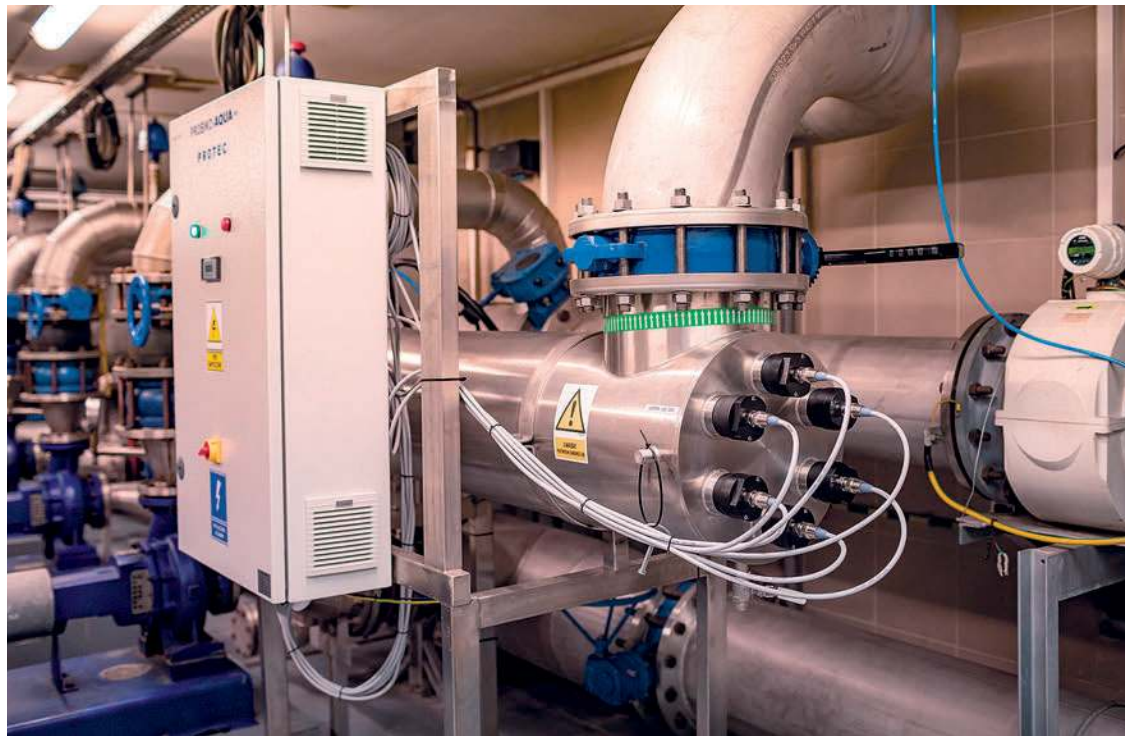
Stacja Uzdatniania Wody Gostkowo, lampa UV służąca do dezynfekcji wody.
