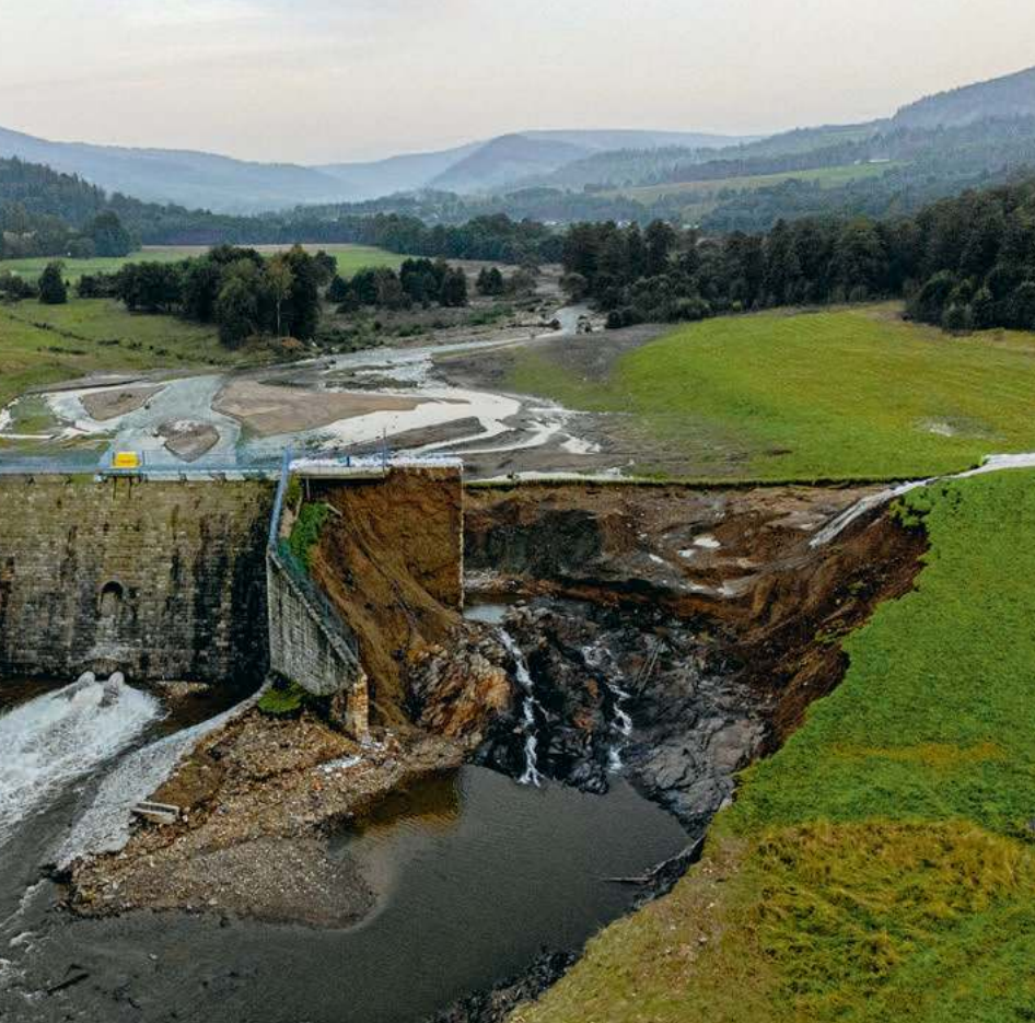
Uszkodzona tama w Stroniu Śląskim. 17 września 2024 r.
