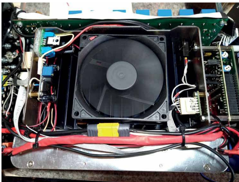
Zamontowana przetwornica DC-DC
