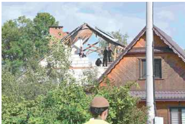
Najdotkliwsze konsekwencje tego zdarzenia dotknęły miejscowość Wyryki-Wola w pow. włodawskim, w woj. lubelskim. Zniszczony został tam dom jednorodzinny. Obiekt trafił w dach budynku, powodując znaczne uszkodzenia. Mieszkańcy domu, starsze małżeństwo, cudem uniknęli obrażeń
