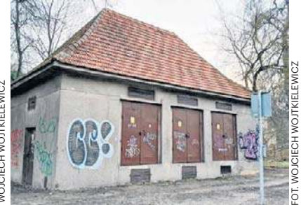
Stacja transformatorowa na Dojlidach
