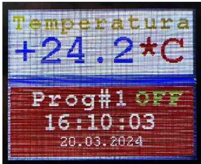
Fotografia 4. Ekran główny termostatu
