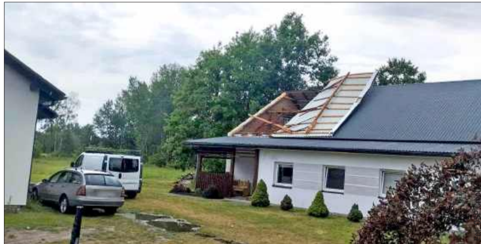
W Cmolasie, przysiółek Dąbrówka, silny wiatr zerwał częściowo dach z budynku mieszkalnego.
