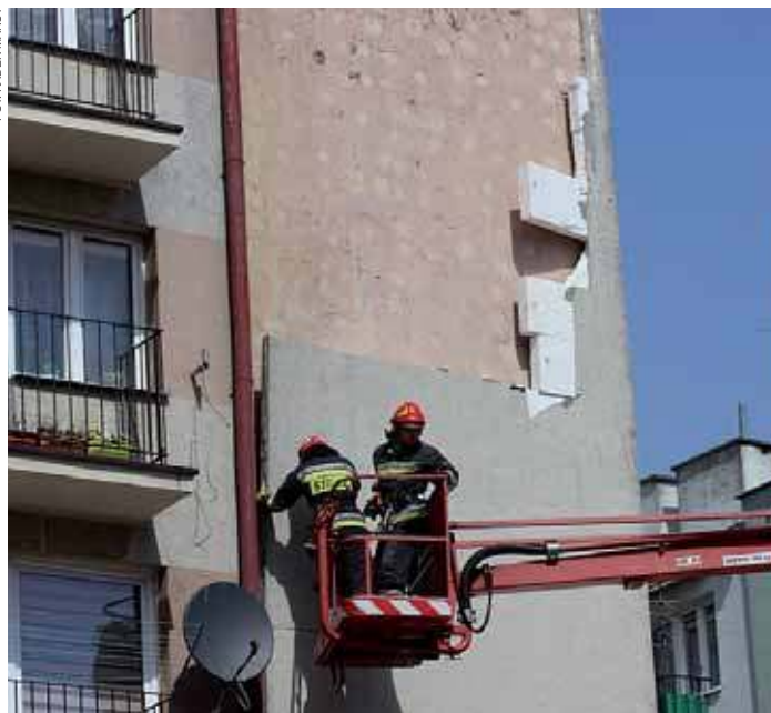
W Ciechanowie silny wiatr był przyczyną oderwania się części elewacji bloku przy ulicy Mikołajczyka
