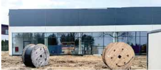
Budowa postępuje w szybkim tempie. Na placu pracują ciężkie maszyny, a inwestycja, mimo swojej skali, nie zwalnia ani na chwilę
