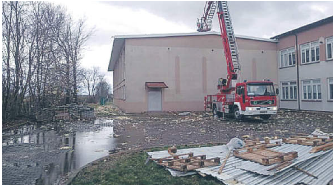
Zerwany dach na hali sportowej przy szkole w Korytnicy.
