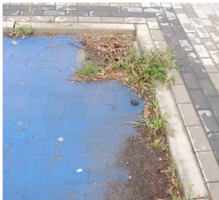
To już niestety standardowy widok, zauważalny nie tylko po opadach deszczu
