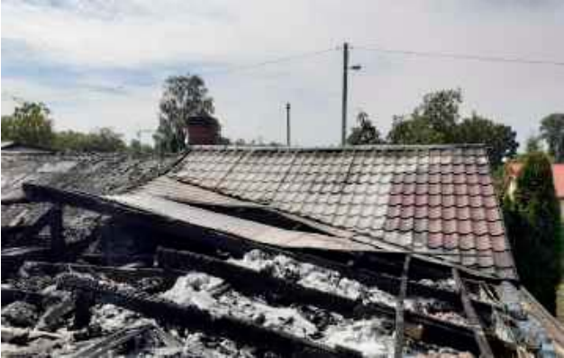
Po pożarze dom nie nadawał się do odbudowy
