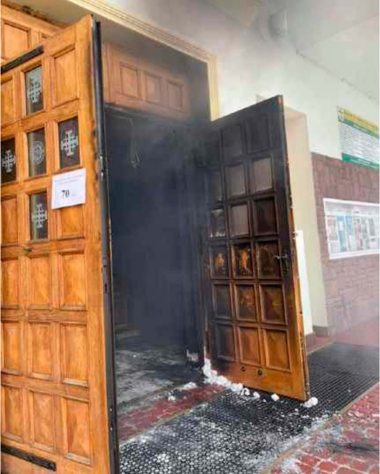
Pożar na szczęście szybko udało się opanować, ale oprócz kotary zniszczeniu uległy również drzwi. Parafia wycenia straty na 100 tys. zł
