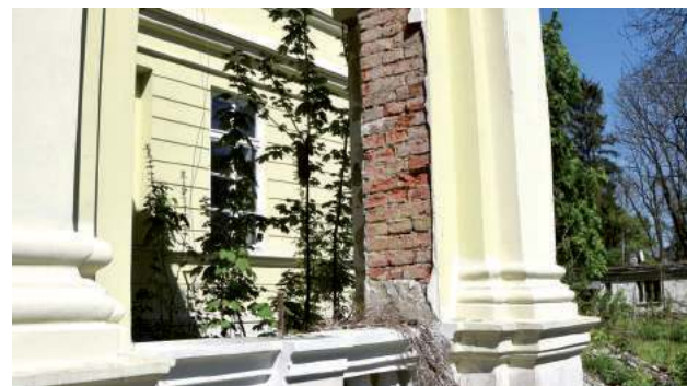
Z elewacji odpada wykonany pięć lat temu tynk
