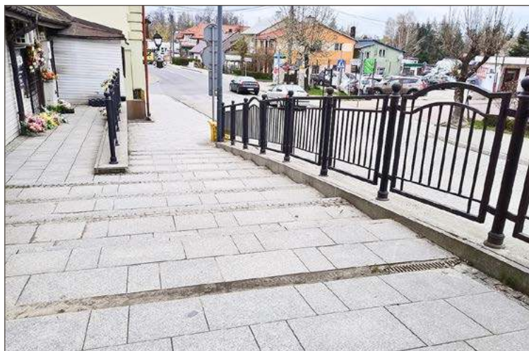
Te schody przy ul. Legionów wymagają przebudowy.
