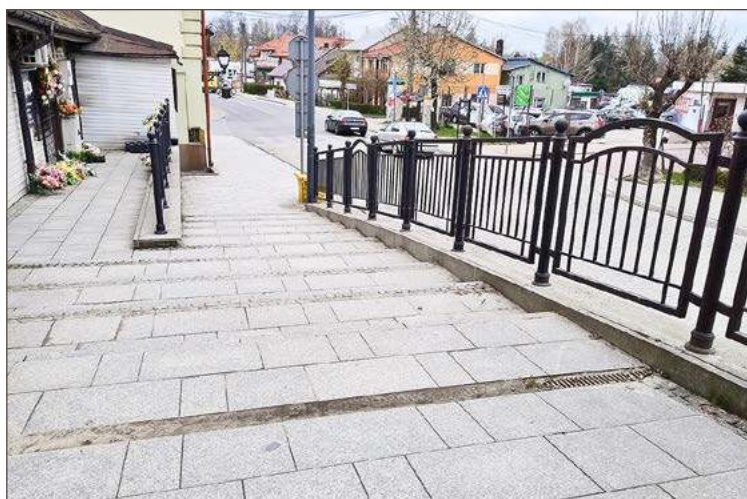
Te schody przy ul. Legionów wymagają przebudowy.
