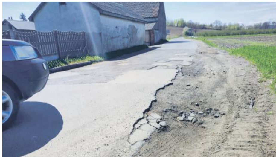
Zniszczone przez ciężarówki pobocze ul. Świerkowej na zakręcie z ul. Modrzewiową wymaga naprawy
