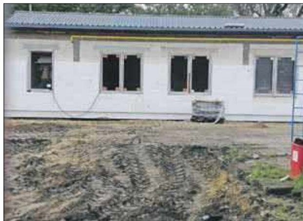
Tak obecnie wygląda budynek przyszłego przedszkola i jego otoczenie, od frontu. Remont miał się skończyć już trzy miesiące temu.
