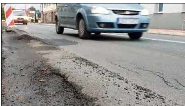
Dziura w jezdni w połączeniu z asfaltowym garbem nie pozwala kierowcom bezpiecznie poruszać się po swoim pasie.
