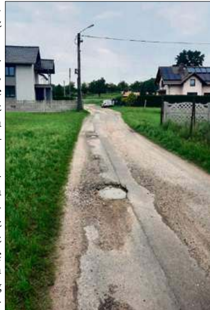
Ulica Nowa (będąca odnogą Cegielnianej) jest w złym stanie.
