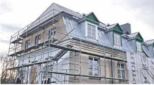
Obecnie ekipy budowlane koncentrują się na pracach wykończeniowych oraz instalacyjnych na poddaszu szkoły
